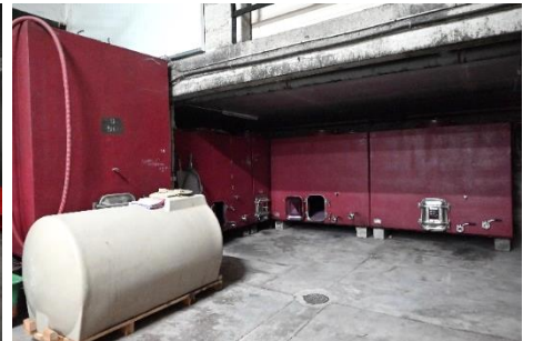
③特定の赤ワイン用のコンクリートタンク
